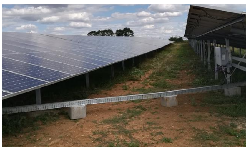
Câbles hors sol – source : LUXEL
